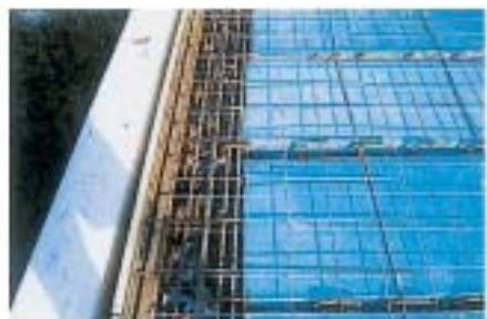
Completamento della struttura con armatura integrativa per le travi principali e con stesa di rete elettrosaldata
