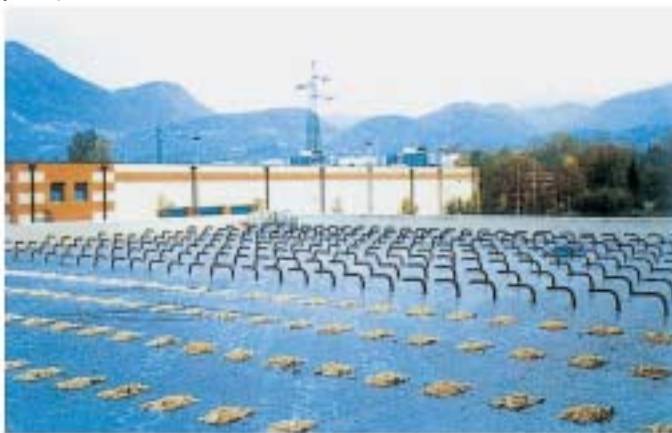
Impermeabilizzazione con guaina Bituthene IWS; successiva formazione dei fori e posa dei connettori FeB44k
